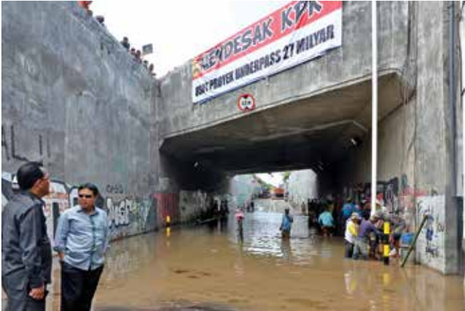
Anggota Komisi V DPR M. Toha dan Yoseph Umarhadi meninjau underpass Makamahaji di Kartosuro, Sukoharjo yang digenangi air
