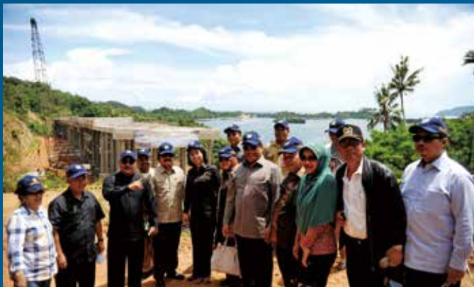
Tim Kunjungan Kerja Komisi V DPR RI dipimpin Michael Wattimena meninjau pembangunan Ringroad Jayapura. Rabu (30/10). Foto: Iwan Armanias/Parle/HR.
