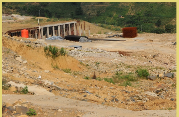
Lokasi amblasnya gedung pada proyek Hambalang
