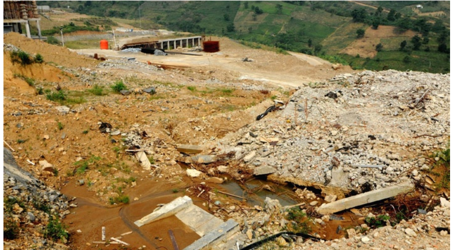
Lokasi amblasnya tanah Hambalang
