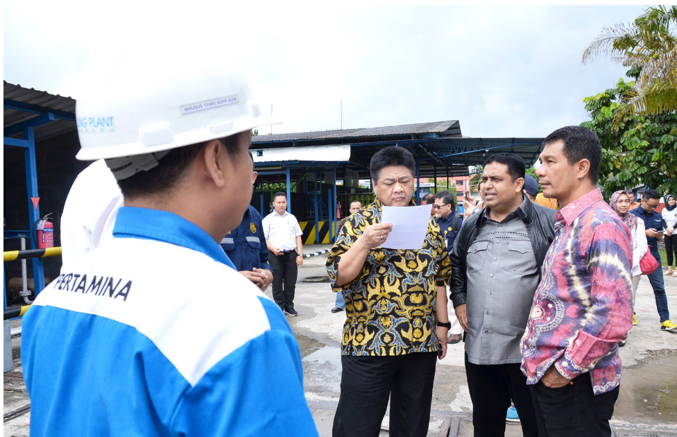
Wakil Ketua Komisi VII DPR RI Ridwan Hisjam memimpin Tim Kunspek Panja Limbah dan Lingkungan tinjau PLTMG 50 Mega Watt di PLTG Teluk Lembu, Provinsi Riau. Foto: Dewi/OD
