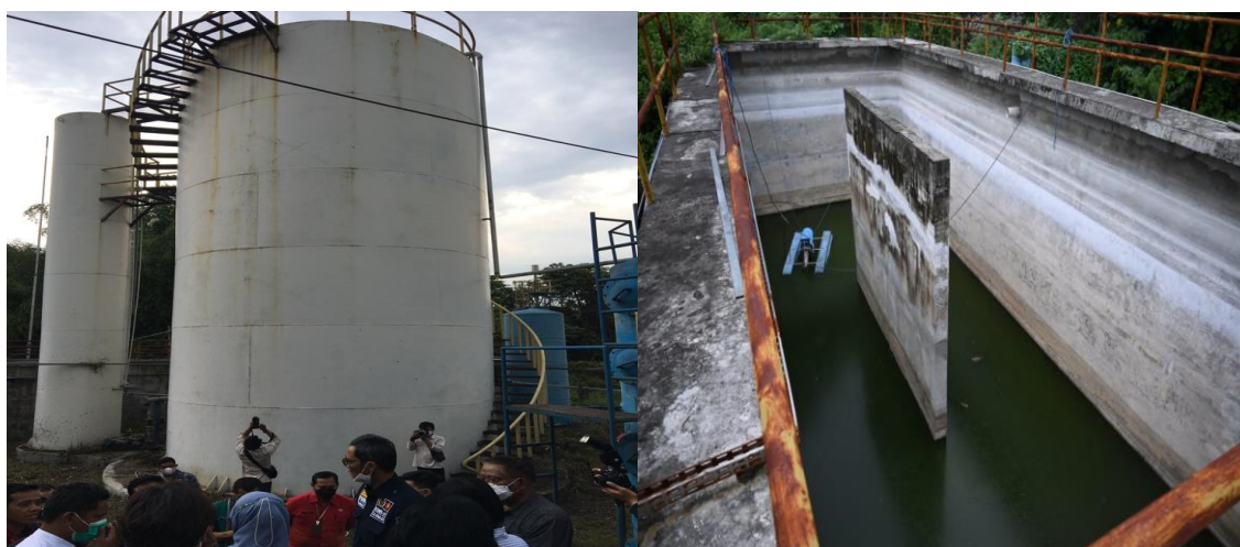
Gambar: Bangunan Instalasi Pengolahan Air Limbah (IPAL) Hibah dari Pemerintah Denmark di Kecamatan Tulung, Kabupaten Klaten, Provinsi Jawa Tengah
